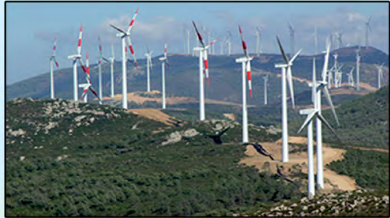
Parc Eolien de Tanger
